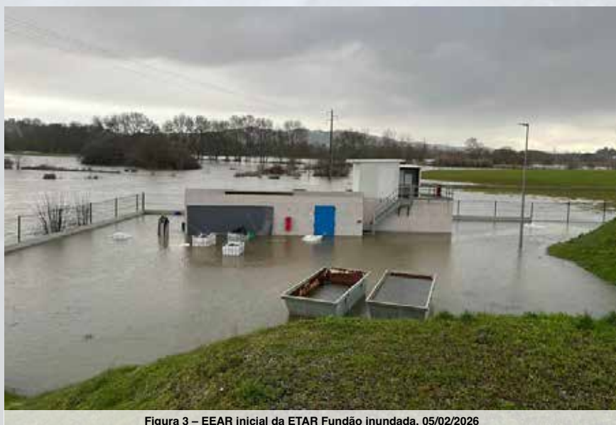
Figura 3 – EEAR inicial da ETAR Fundão inundada, 05/02/2026
