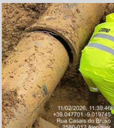
10 de fevereiro - Rotura em Casais do Bruxo – Sistema Alenquer-Torres
