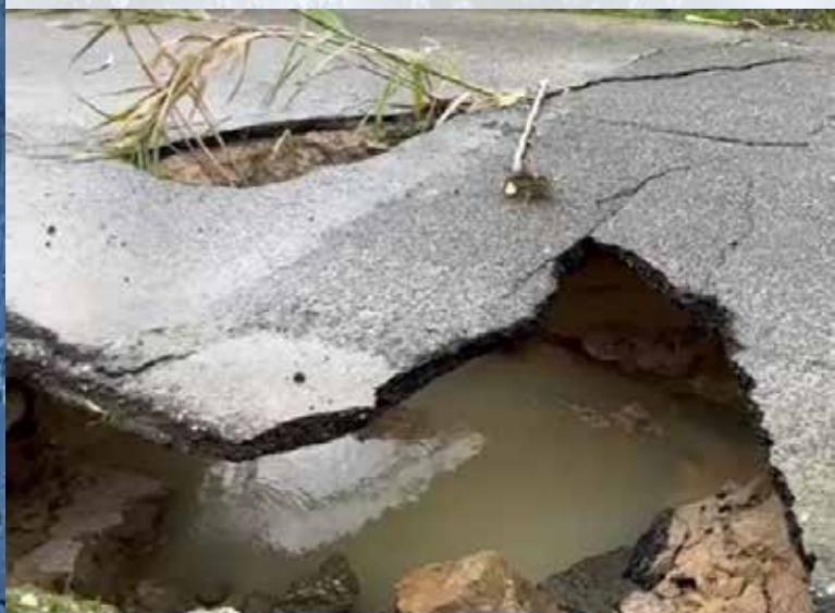
Rotura na Ponte de Monfalim
