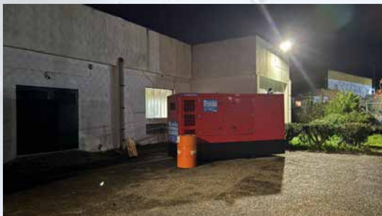
29 de janeiro – gerador de 250 kVA na Estação Elevatória de Curvaceiras (Médio Tejo Norte).
