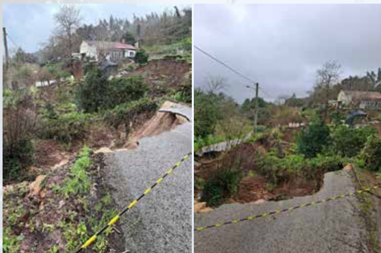
18 de fevereiro - Zona do deslizamento de terras em Maiorga
