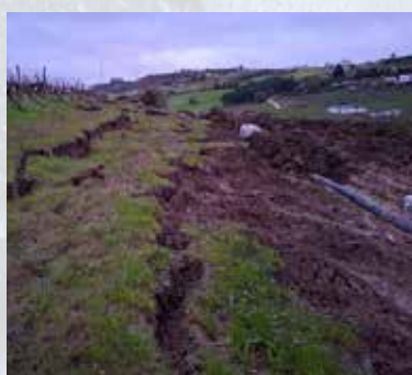
Carmões – Conduta provisória em bypass e terrenos adjacentes
