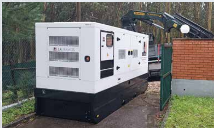
30 de janeiro - Gerador de 400 kVA na Estação Elevatória de Fontelas (Sistema Oeste)
