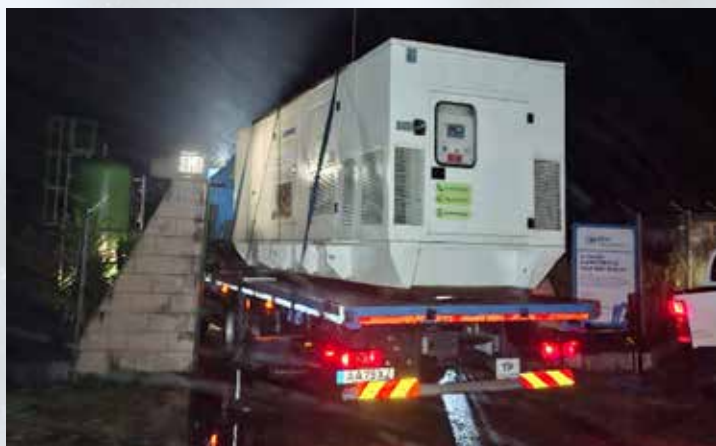
29 de janeiro - Gerador de 630 kVA na chegada à Estação Elevatória de Vale de Porcas (Médio Tejo Norte)
