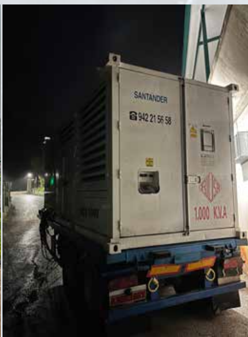
Geradores de Emergência
