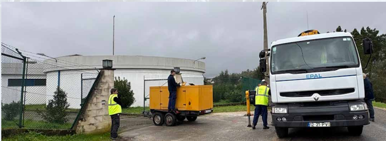
1 de fevereiro – desmontagem do gerador de 100 kVA na Estação Elevatória de Madeiras após restabelecimento de energia elétrica da rede (Médio Tejo Sul).
