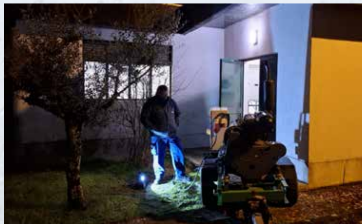
30 de janeiro - Gerador de 40 kVA na Estação Elevatória da Loureira – Fátima (Médio Tejo Norte)
