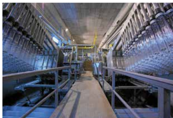
Na época balnear, a água filtrada (filtração em areia) é distribuída por 2 canais paralelos, onde ocorre a desinfecção por radiação ultra-violeta. Na época balnear, esta é a etapa final de tratamento da fase líquida.
